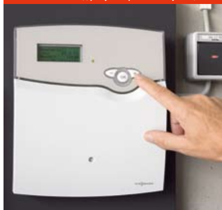
Рис. Е.1.3-1 Ввод регулятора в эксплуатацию
